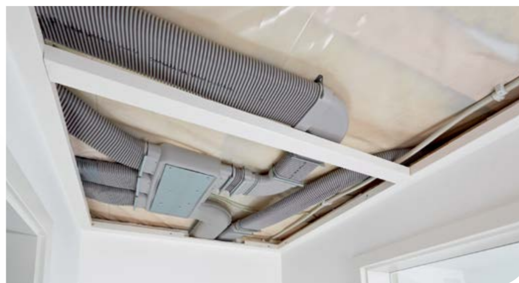
Integracja rur Zehnder Onfloor w suficie podwieszanym
